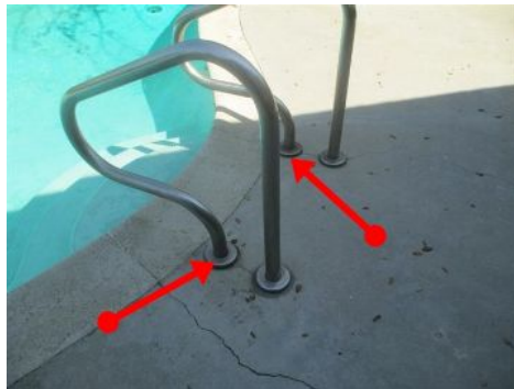
loose railing / no visible equipotential bonding conductor
